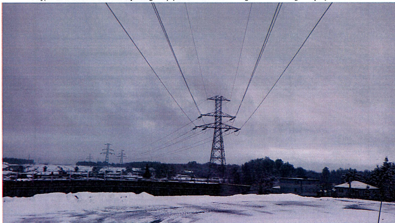
Zdjęcie nr 2. Dwutorowa Linia Wysokiego Napięcia 220 kV Adamów - Zgierz / Janów – Zgierz - przęsło nr 7A - 8.
