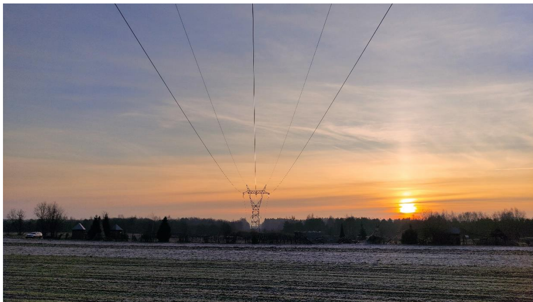
Zdjęcie nr 5. LWN 220 kV Janów – Zgierz – Adamów – widok fragmentu obiektu; prześło nr 82 – 83.
