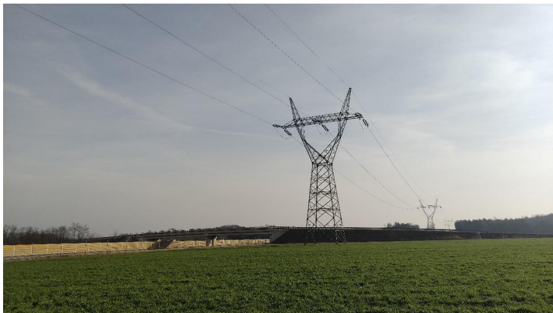
Zdjęcie nr 3. LWN 220 kV Janów – Zgierz – Adamów – widok fragmentu obiektu; przęsło nr 71A – 71.
