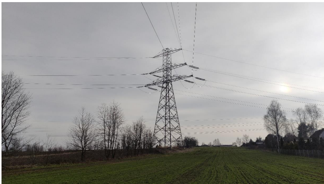
Zdjęcie nr 1. LWN 220 kV Janów – Zgierz – Adamów – widok fragmentu obiektu; przęsło nr 25 – 55.
