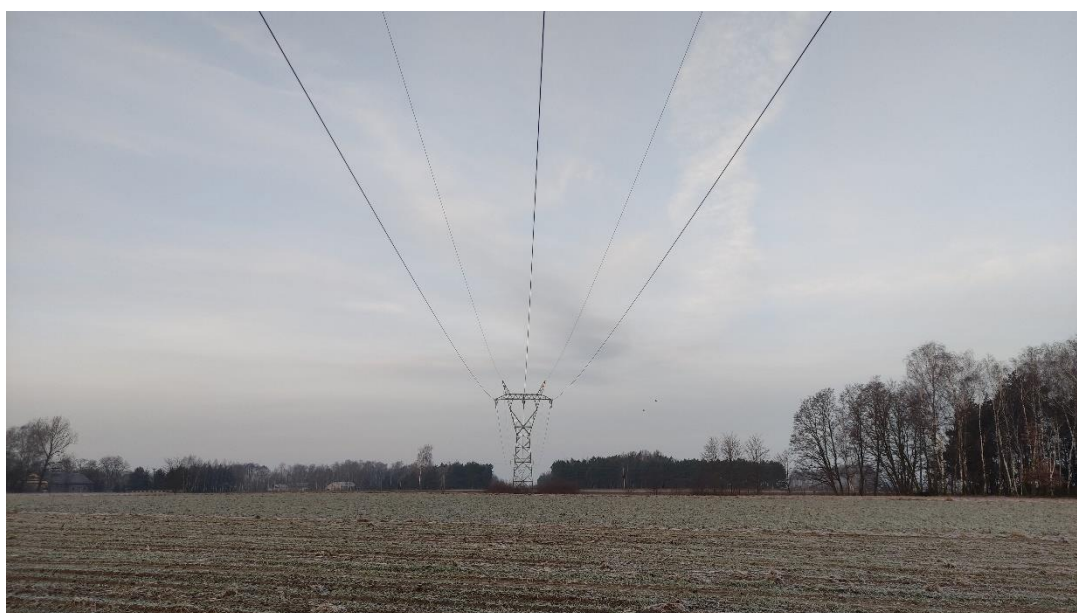
Zdjęcie nr 6. LWN 220 kV Janów – Zgierz – Adamów – widok fragmentu obiektu; prześło nr 82 – 83.
