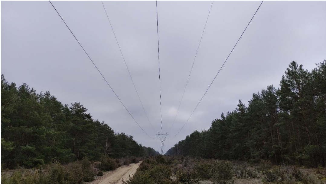
Zdjęcie nr 9. LWN 220 kV Janów – Zgierz – Adamów – widok fragmentu obiektu; przęsło nr 181 – 182.
