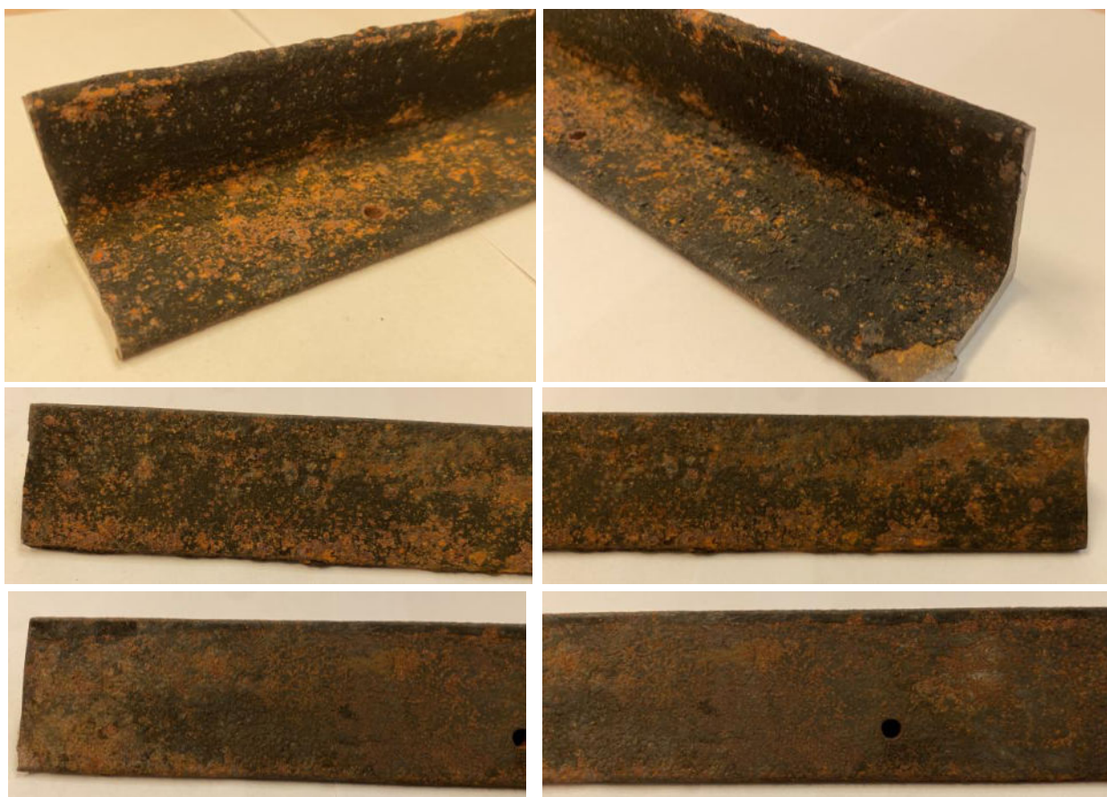
Rys. 3. Zdjęcia powierzchni próbki 9/2024/1
