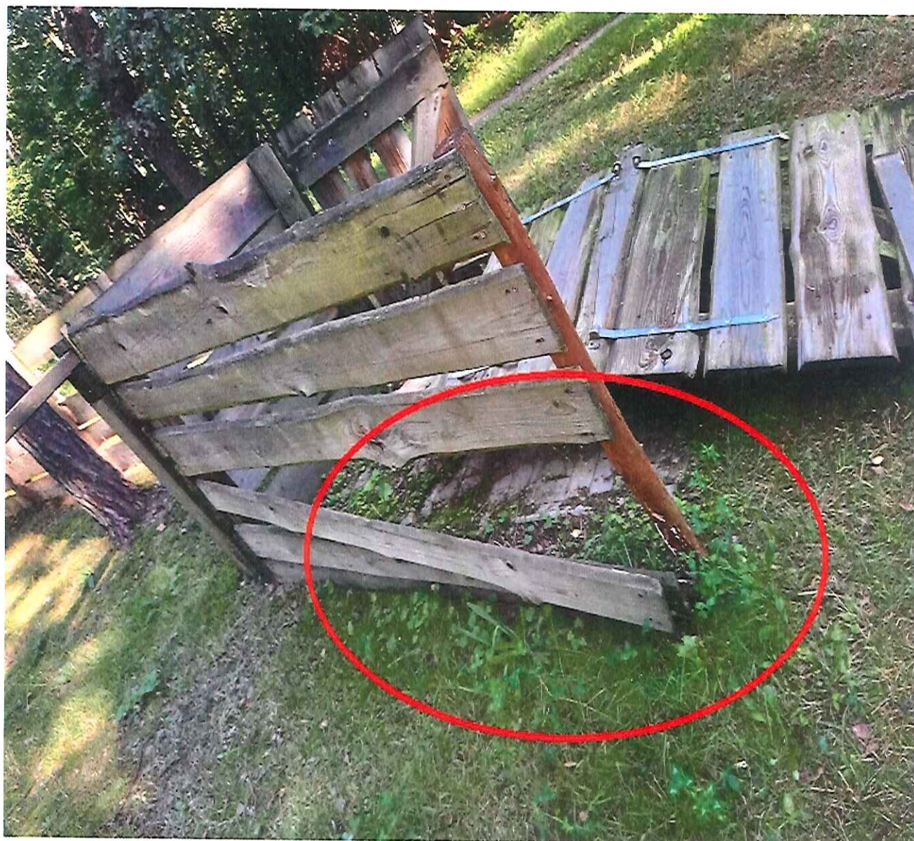
Zgniły słup do wymiany nr 2 Naprawa oderwanego ogrodzenia
