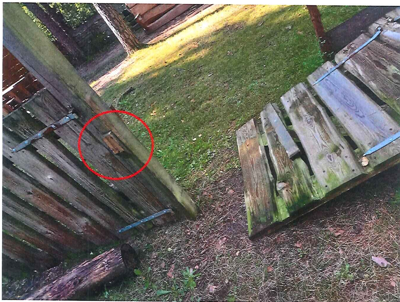
Uszkodzone zamknięcie bramy
