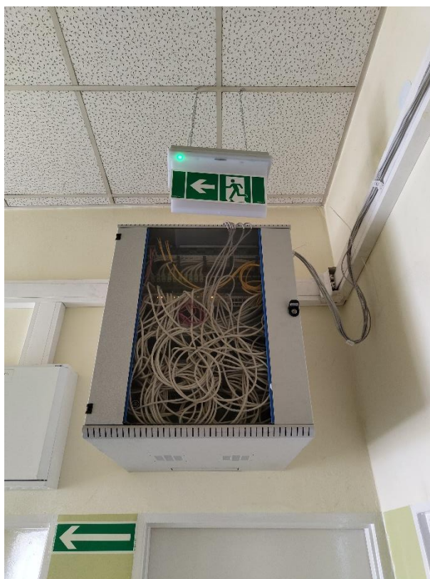
Fot 7. Szafa teletechniczna w budynku okulistyki.
