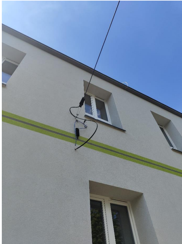
Fot 3. Uszkodzony Kabel światłowodowy – budynek administracji.
