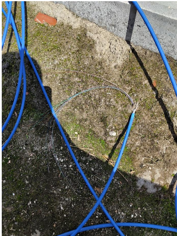
Fot 4. Miejsce uszkodzenia kabla światłowodowego.
